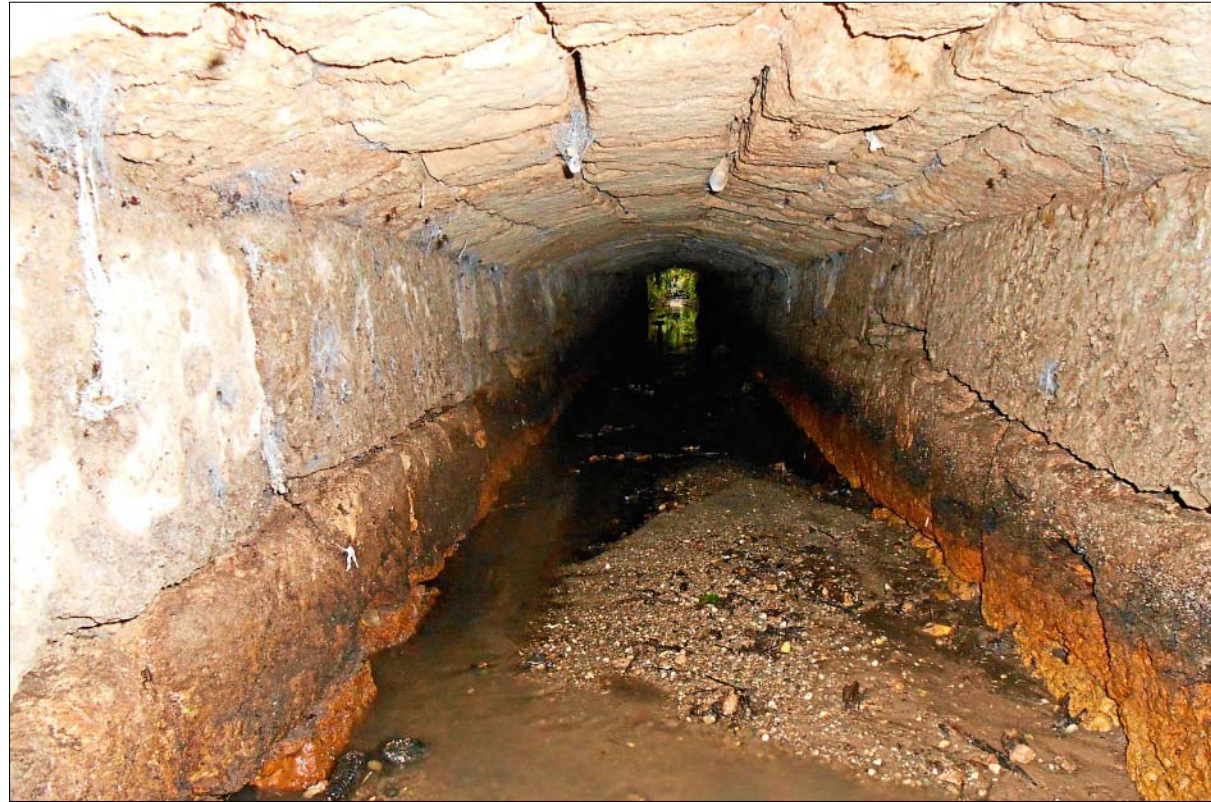
20 Zentimeter unter der Straße zur Brauerei befand sich der Triebwasserkanal. Mittlerweile ist dieser Kanal abgelassen. – Fotos: Hopfgartner
